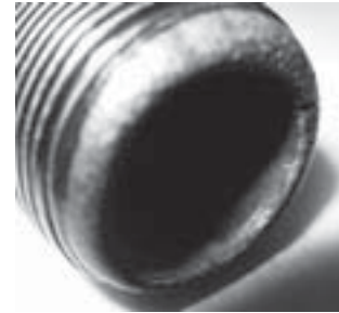
写真16 白雲 管尻のつば腐れ
