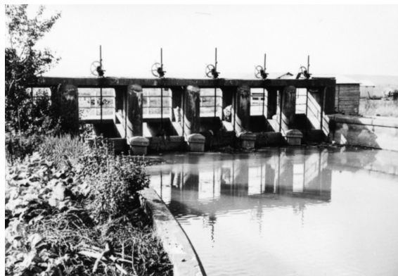
写真3 完成したコンクリート水門 昭和35年撮影。川尻土地改良区蔵。
