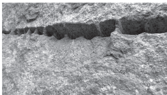
写真7 矢穴口の剥落
