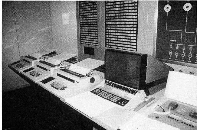
写真4 機械棟に設置されているモニタリング装置。
